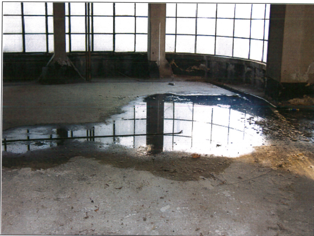
IMMAGINE N.25 - INTERNO – PIANO QUARTO – INFILTRAZIONI
