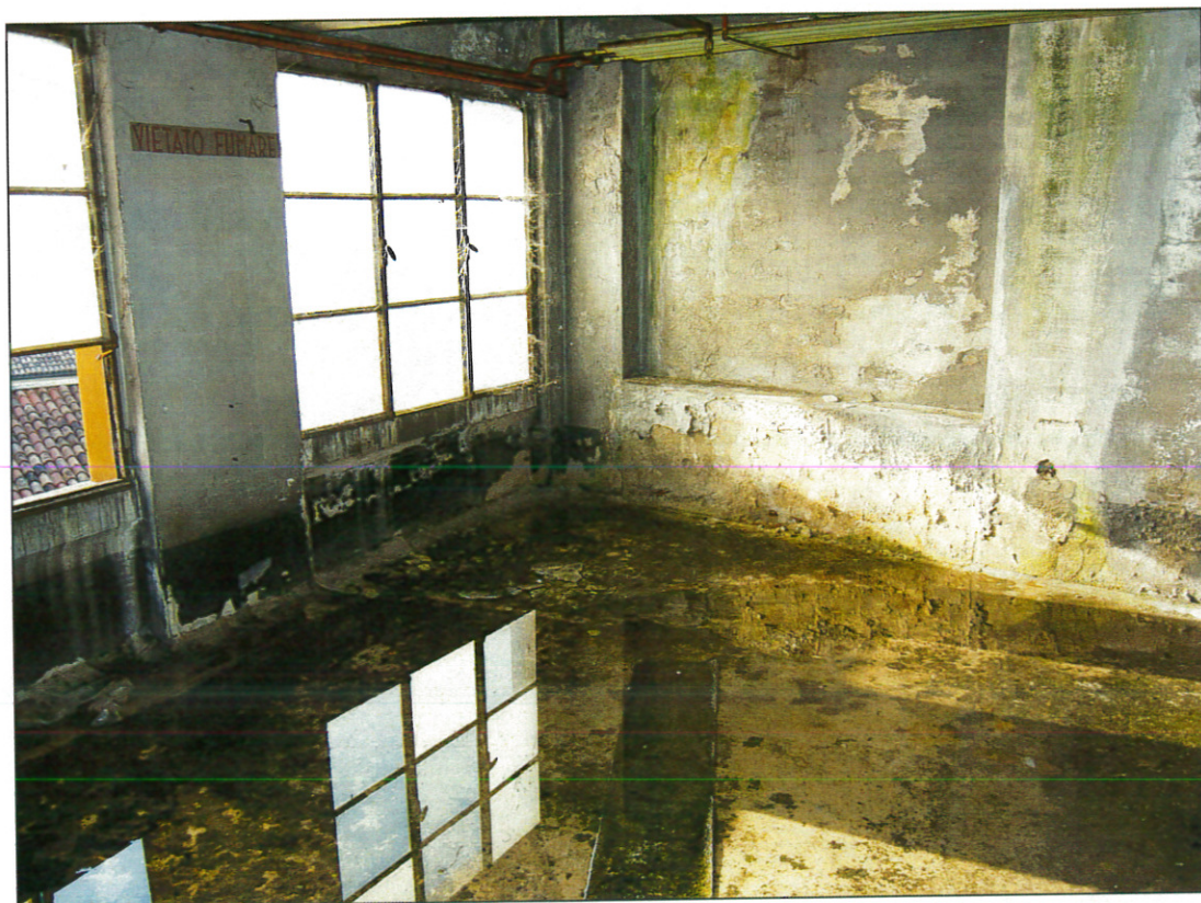
IMMAGINE N.24 - INTERNO PIANO SETTIMO – PERDITE DA COPERTURA
